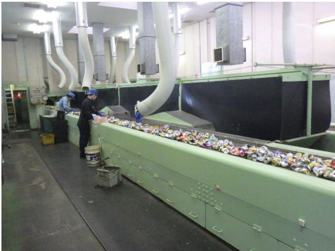
手選別室（びん、缶、ペットボトルのレーンがあり、手作業でポリ袋や異物を除去している）
