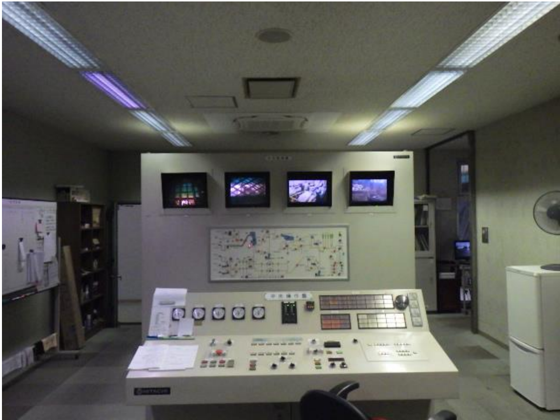
中央操作室（主要な機械の運転や監視を行うところ）
