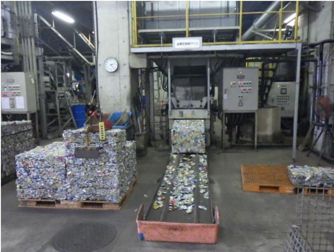
金属圧縮機（選別したアルミ缶やスチール缶を圧縮してブロック状に加工する機械）
