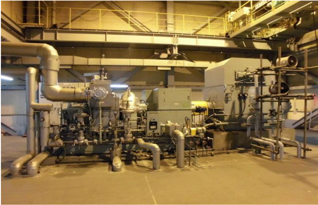
蒸気タービン発電機（発電能力:2,470kw/h）
