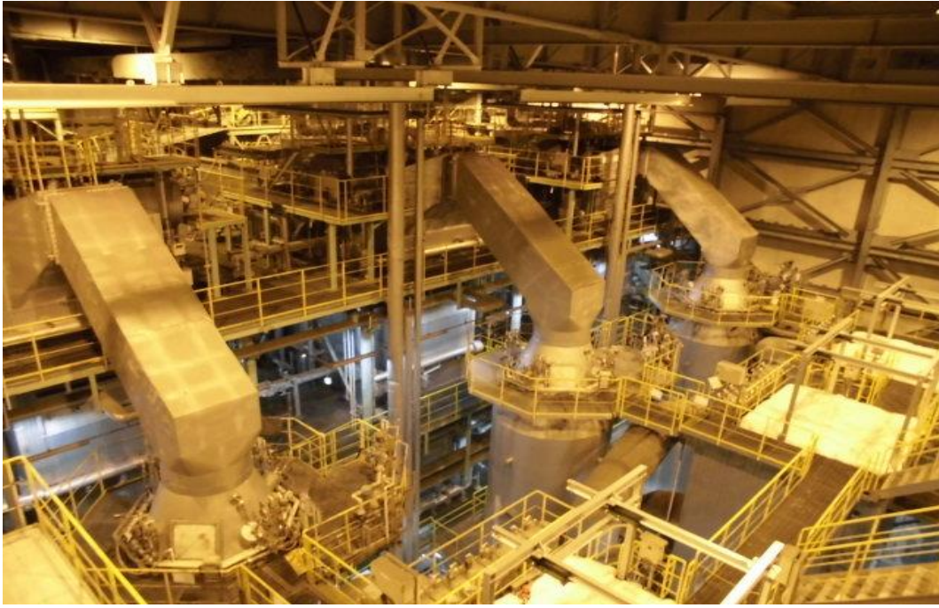
清掃工場内、設備機器
