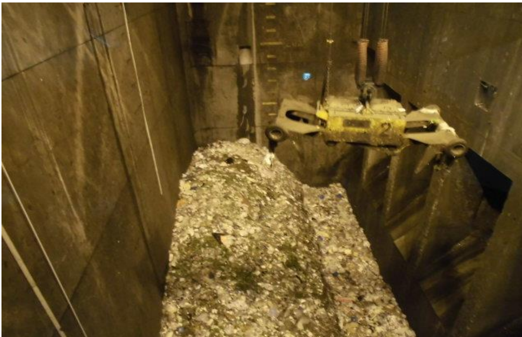
ごみピット、ごみクレーン
