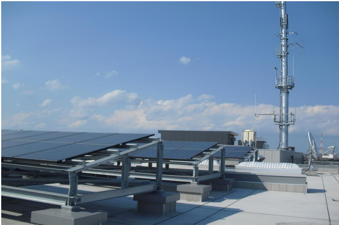
市庁舎屋上の太陽光発電システム（20kW）
