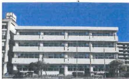
校舎外観(改修後)外部塗装改修 バルコニー手摺塗装改修 バルコニー防水改修
