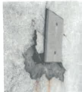
浮いている外壁
