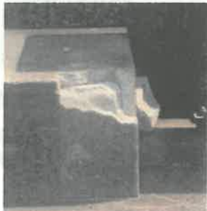
スタンド内階段の破損
