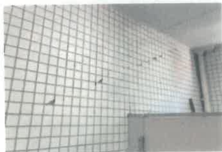
全体的な亀裂
