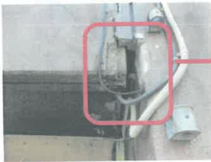
平成 28 年度に落下した箇所
