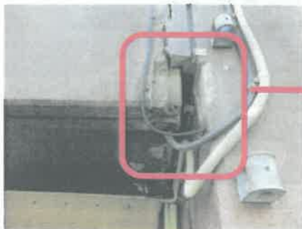
平成 28 年度に落下した箇所
