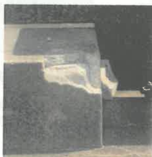
スタンド内階段の破損
