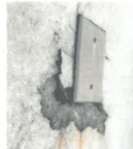
浮いている外壁
