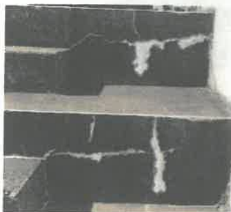
スタンド内階段の亀裂
