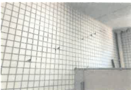
全体的な亀裂
