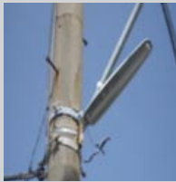
既設20W防犯灯
