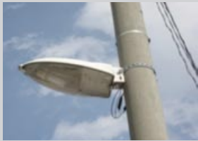
既設32W防犯灯
