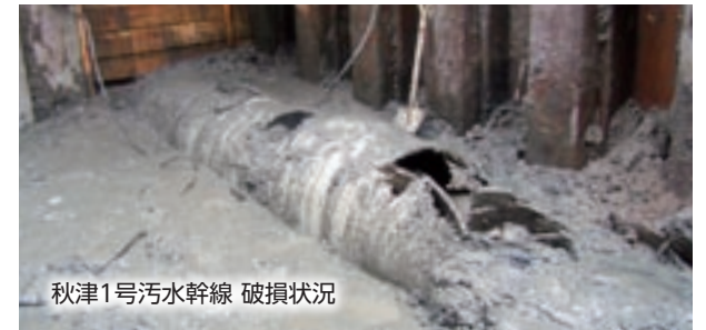
幹線会合部の陥没状況
