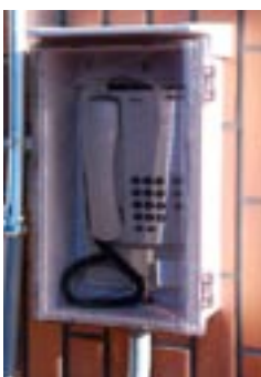
駆け込み通報装置
