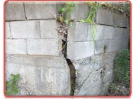
壁が壊れている
