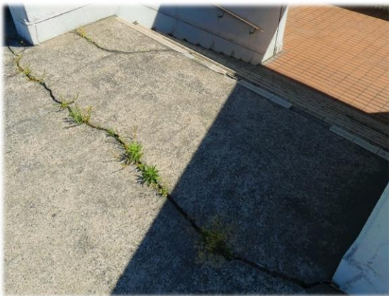
秋津サッカー場観客席に係る階段のひび割れ
