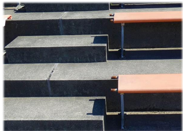
秋津野球場観客席ベンチの破損 （着座部ズレによる鉄棒の露出）
