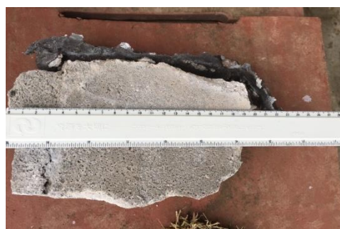
落下したコンクリート片(横 22cm×縦 16cm)
