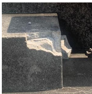
スタンド内階段の破損
