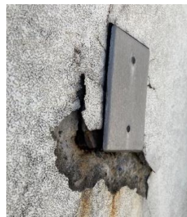
浮いている外壁
