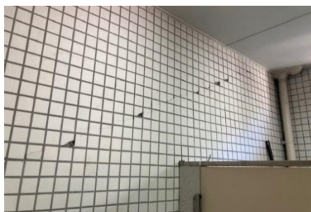
全体的な亀裂
