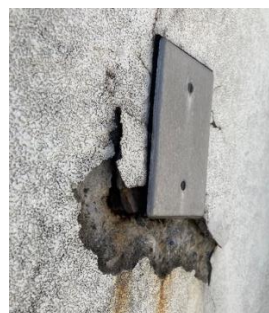
浮いている外壁
