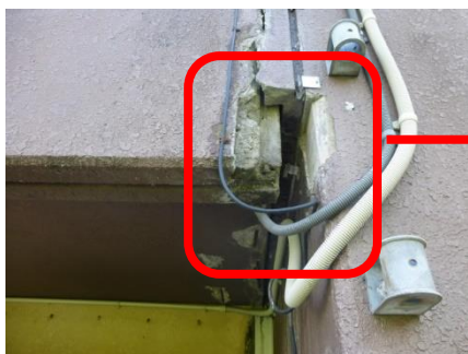
平成 28 年度に落下した箇所
