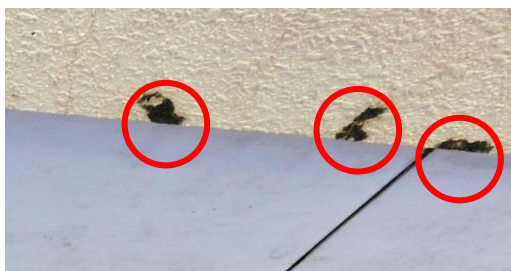
雨漏りしている天井
