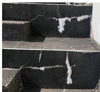
スタンド内階段の亀裂
