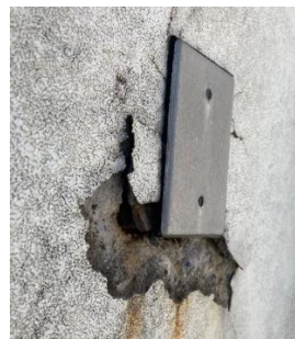
浮いている外壁
