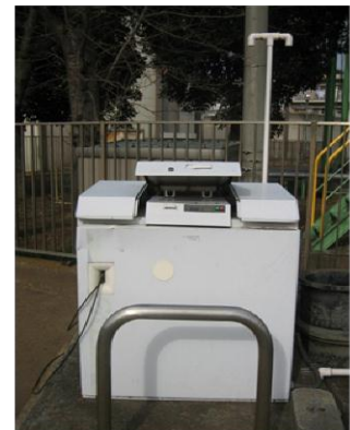
天然ガス充填機
