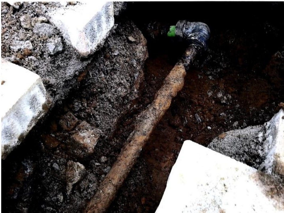
経年劣化した白鋼管の状況
