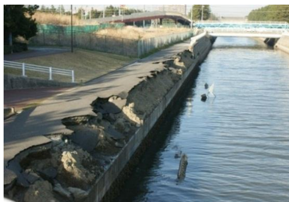
東日本大震災で崩壊した歩道
