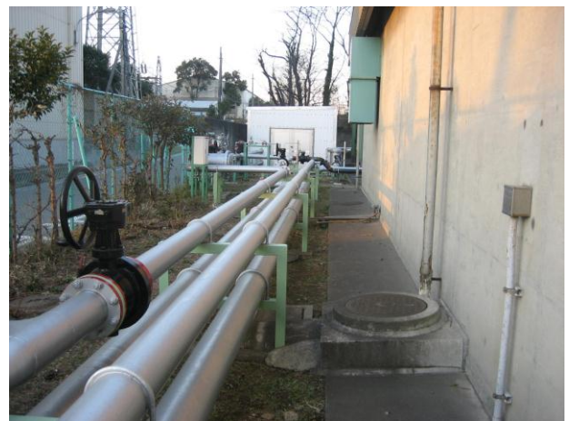
県内産天然ガスを受け入れているパイプライン
