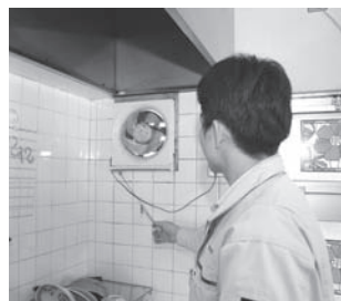
▲給排気設備の点検
