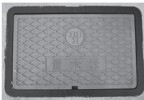
水道メーターボックス
