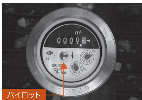
水道メーター(矢印部分がパイロットです)
