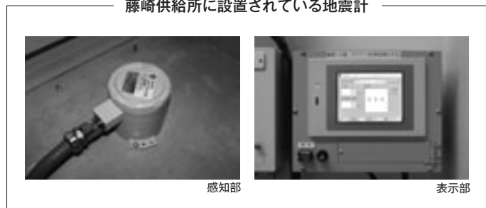
藤崎供給所に設置されている地震計
