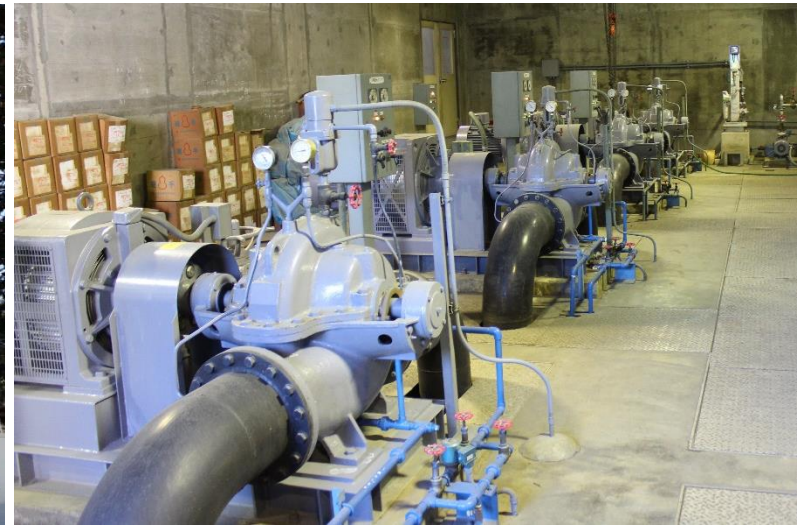
(第3給水場の配水ポンプ)
