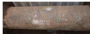
埋設後40年経過した水道管
