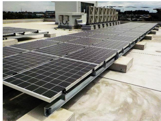
ポンプ電気棟屋上部 太陽光発電パネル
