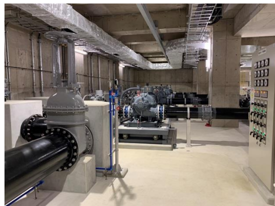
配水ポンプ室
