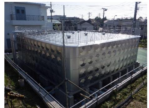
第1給水場ステンレス浄水池
