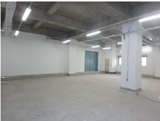
ポンプ電気棟 2 階電気室
