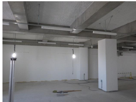
電気棟 2 階電気室
