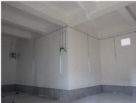
電気棟 1 階発電機室
