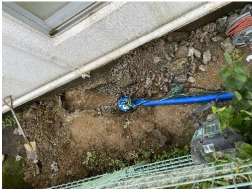
敷地内の水道管からの漏水
