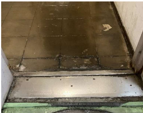
渡り廊下部分の浸水
