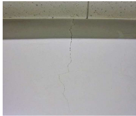
梁のひび割れ
