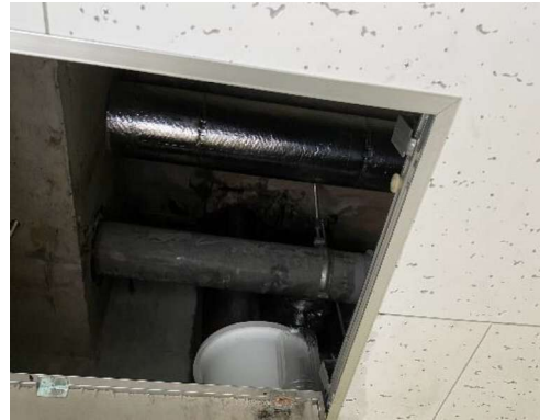
天井からの雨漏り
