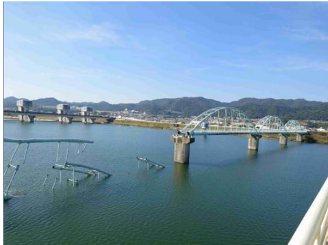
【和歌山県】老朽化による水管橋崩落
