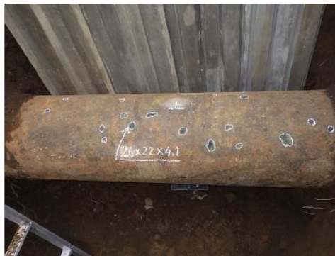
【習志野市】埋設後40年経過した水道管 白色丸印:腐食により生じたくぼみ
