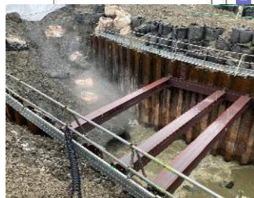
陥没箇所 2025年1月
