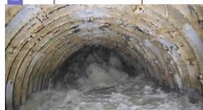
陥没箇所 直下流の管内
