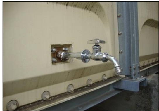
【受水槽の給水栓】
