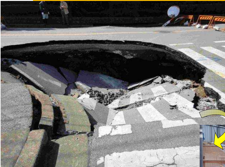
香澄地区の 道路陥没
