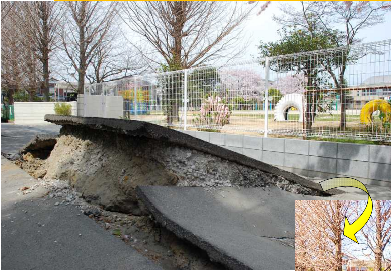
袖ヶ浦地区 隆起した道路
