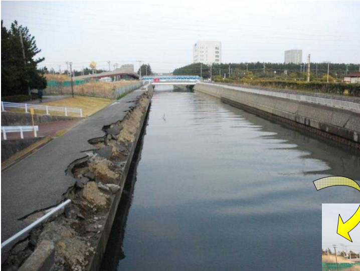
芝園地区 護岸が崩落
