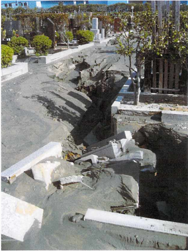
海浜霊園の液状化状況
