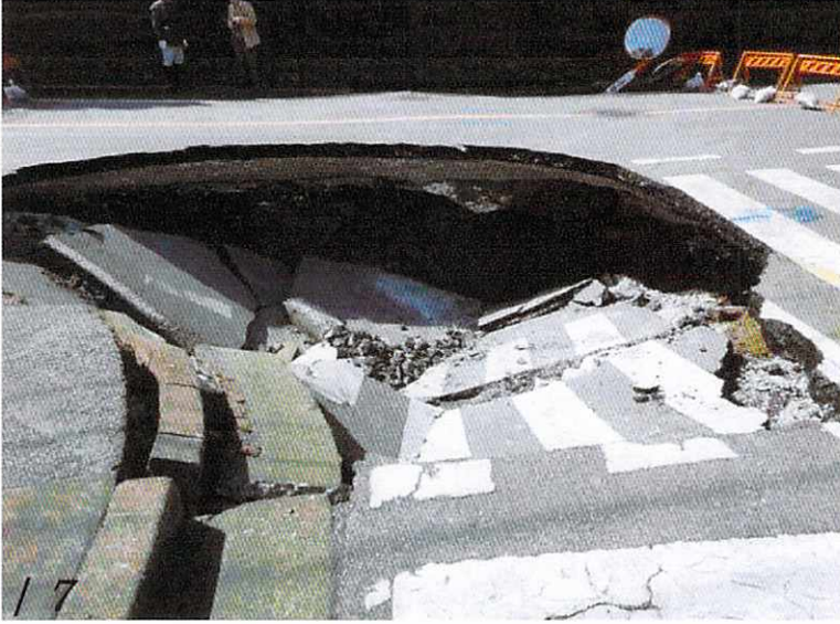
香澄地区 道路の陥没
