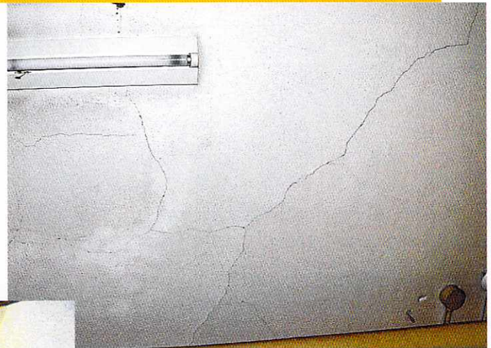
天井のひずみ
