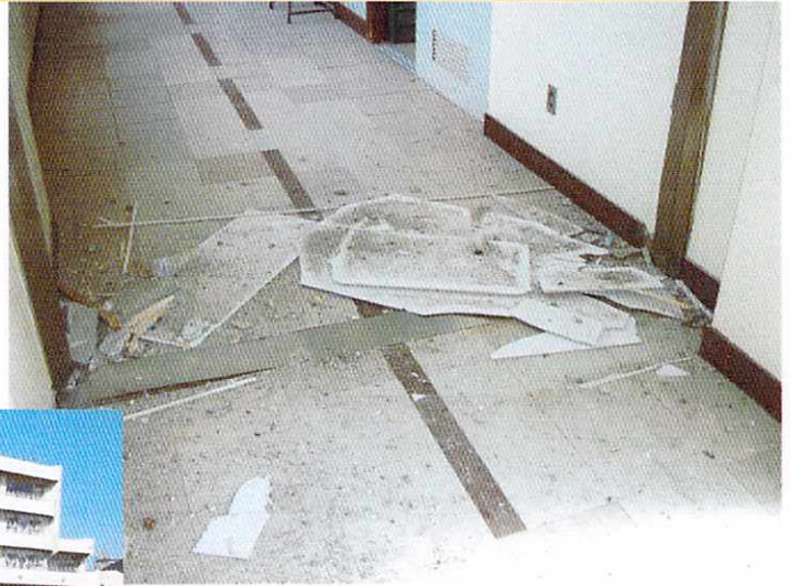
校舎内構造物落下
