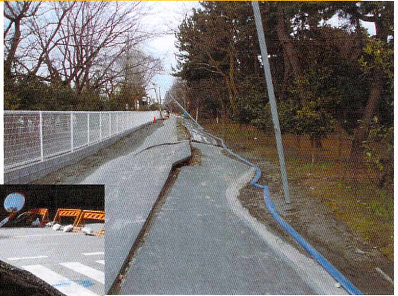
袖ヶ浦地区 道路の隆起
