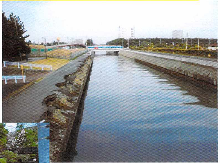
芝園地区 崩落した菊田川護岸
