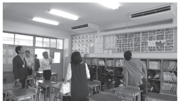
教室に設置されたエアコン
