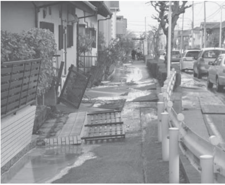
3.11 東日本大震災時の液状化被害にあった住宅地（香澄3丁目）
