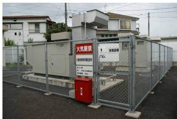
非常用発電機（藤崎1丁目）
