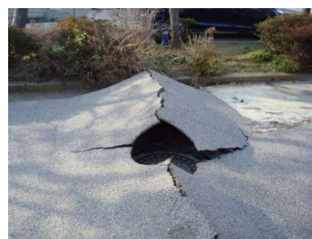
液状化による被害状況2
