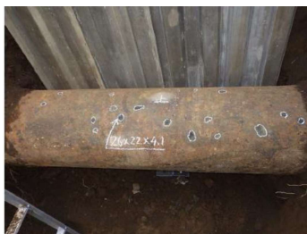
埋設後40年経過した水道管 白色丸印：腐食により生じたくぼみ
