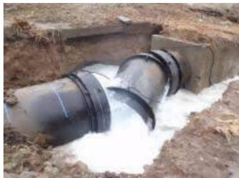
【宮城県】 東日本大震災による送水管 離脱
