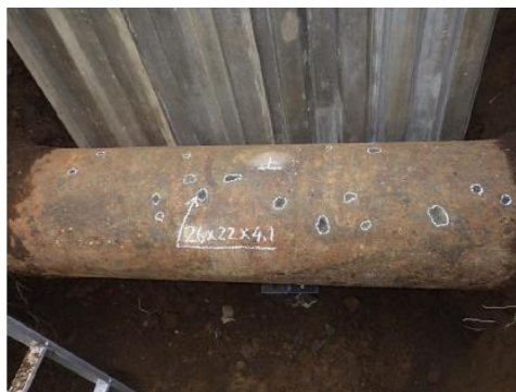
【習志野市】 埋設後40年経過した水道管 白色丸印:腐食により生じたくぼみ
