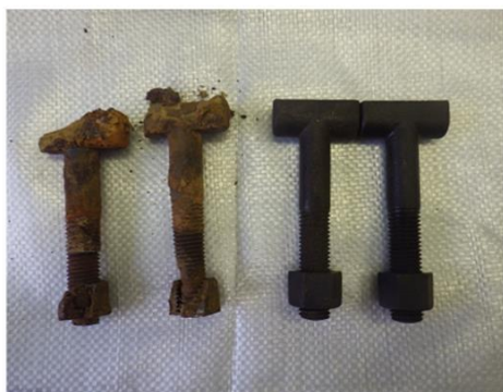
【習志野市】 水道管を接合するボルト・ナット (左) 40年経過 (右) 新品
