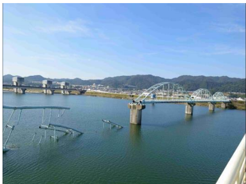
【和歌山県】 老朽化による水管橋崩落
