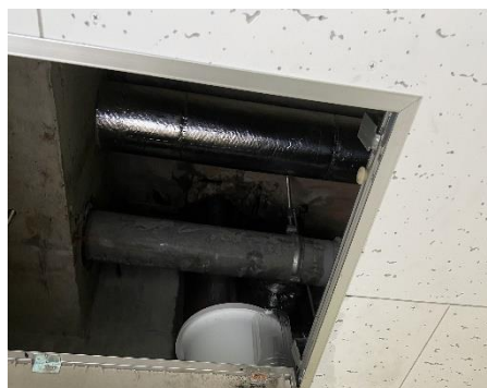
天井からの雨漏り
