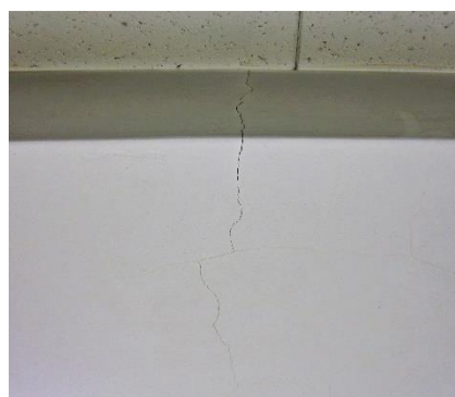
梁のひび割れ
