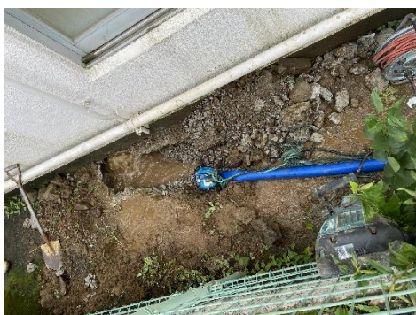
敷地内の水道管からの漏水
