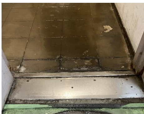
渡り廊下部分の浸水
