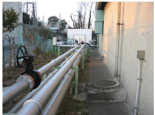
県内産天然ガスを受け入れているパイプライン (東習志野6丁目)
