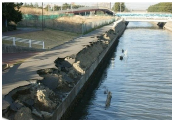
東日本大震災で崩壊した歩道
