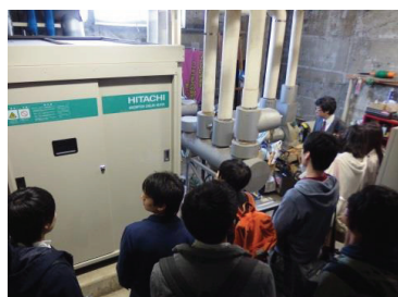
吸収式冷温水機
