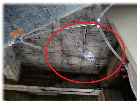
ステージ裏の天井にはヒビ割れや雨漏りの跡が！
