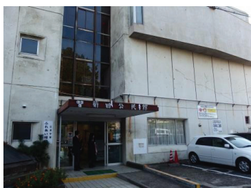
外壁にも傷みが...
