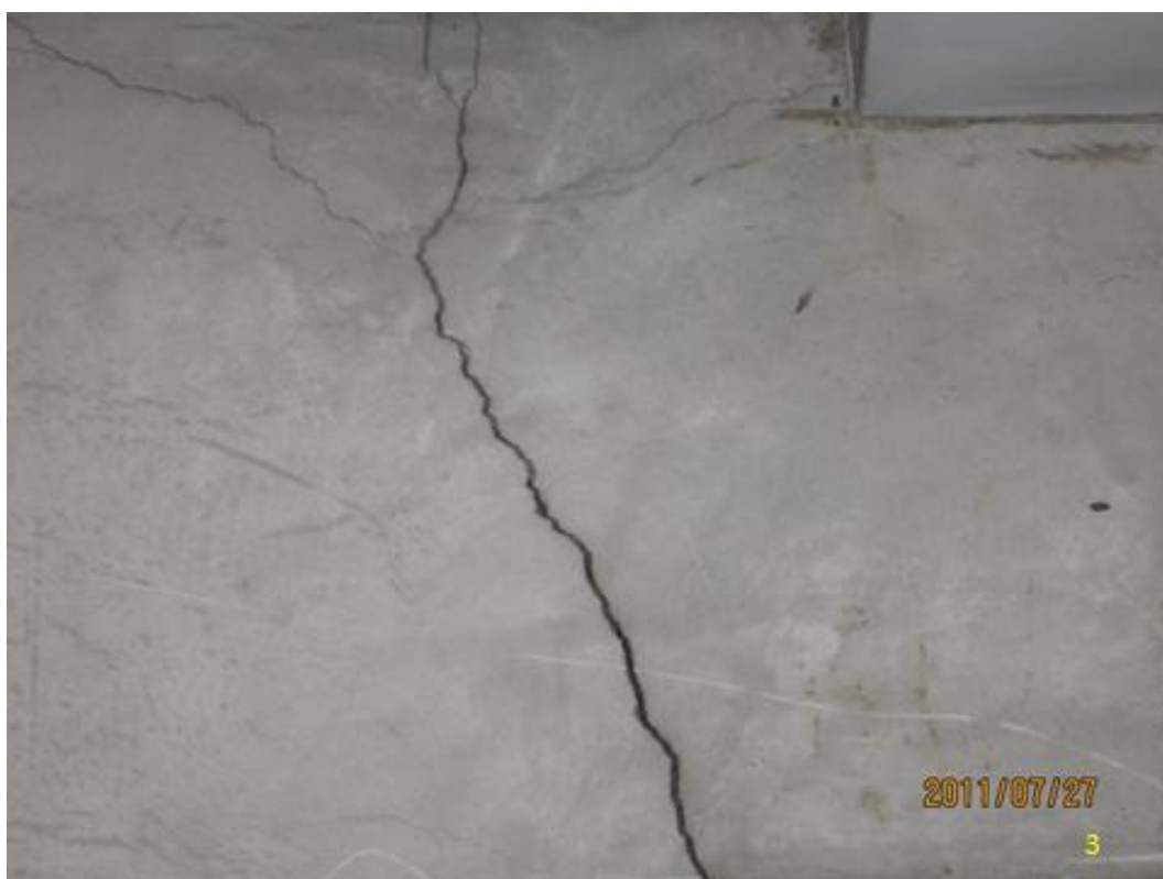
壁面のひび割れ
