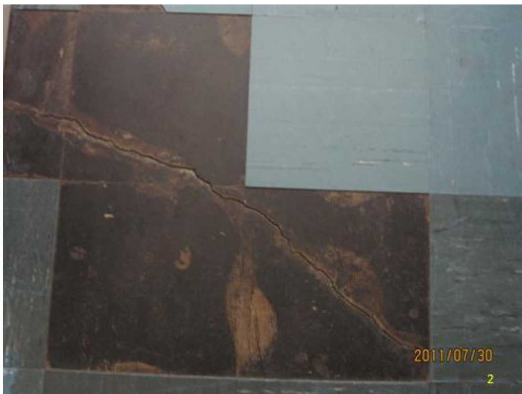
床のひび割れ
