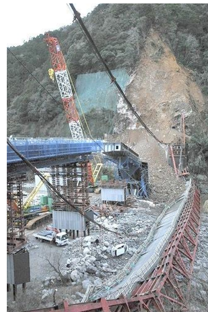
2015.1.31 浜松市原田橋 崩落 2名死亡
