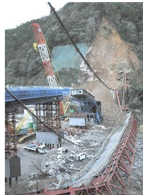
2015.1.31 浜松市原田橋 崩落 2名死亡
