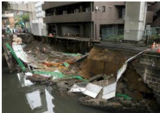
2013.10.15 東京都港区 区道崩落
