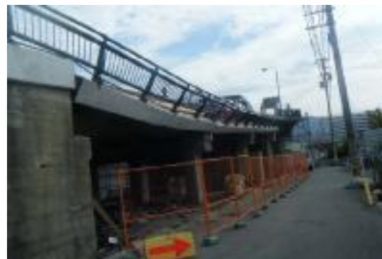
2011.10.25 福岡県直方市 陸橋崩落
