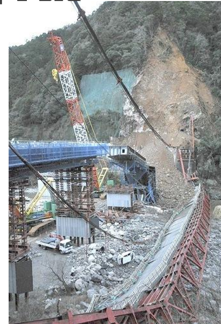
2015.1.31 浜松市原田橋 崩落 2名死亡
