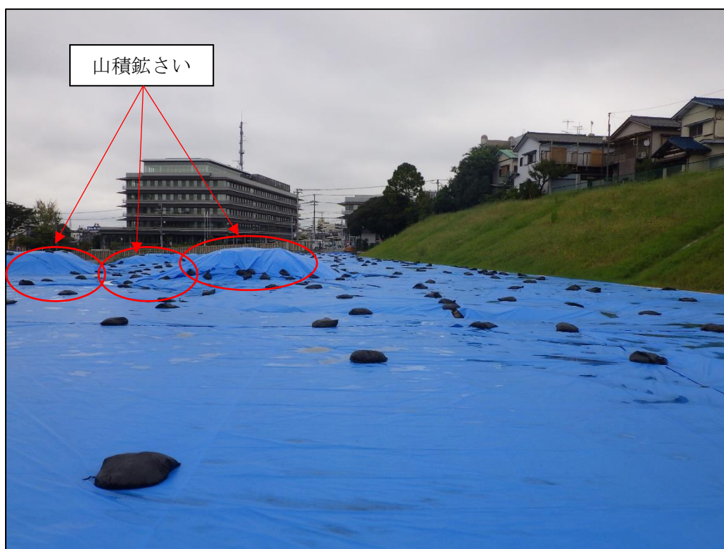
写真 1.2 (2) 飛散防止ブルーシート状況（南側より撮影）
