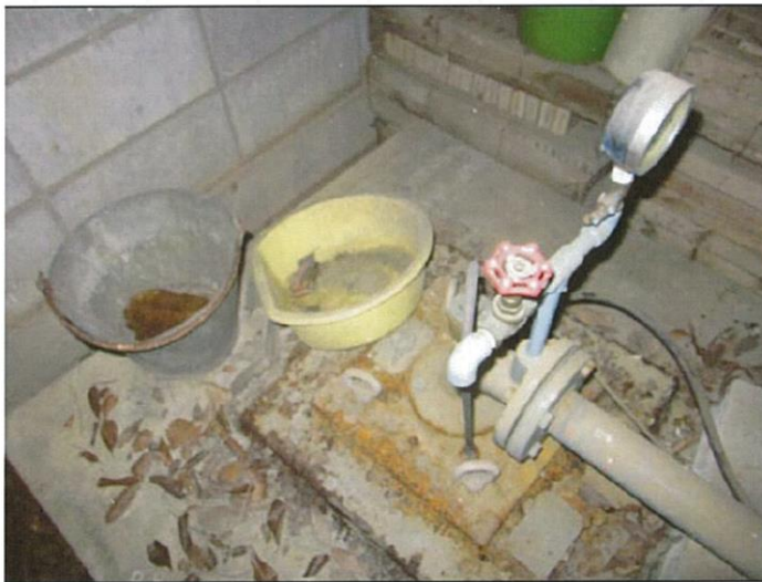
No. 95 屋外 設備置場廻り ※井戸ポンプ確認
