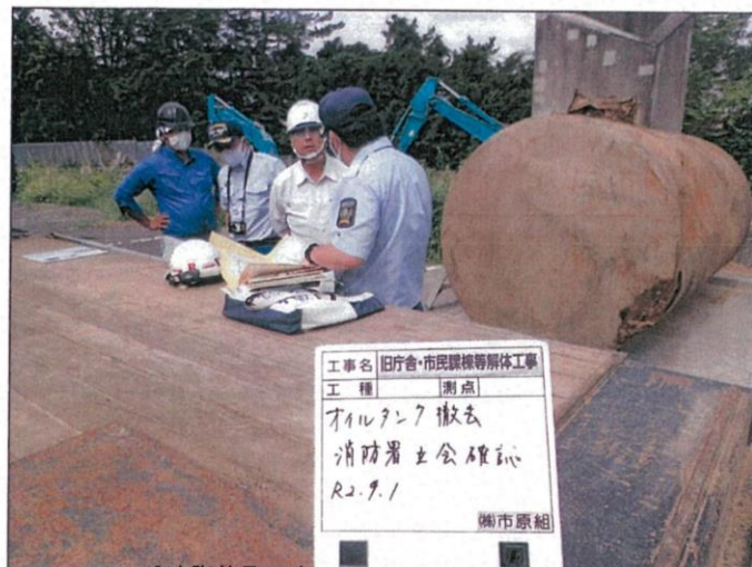
図2.1.4 (2) オイルタンクによる汚染のおそれの状況
