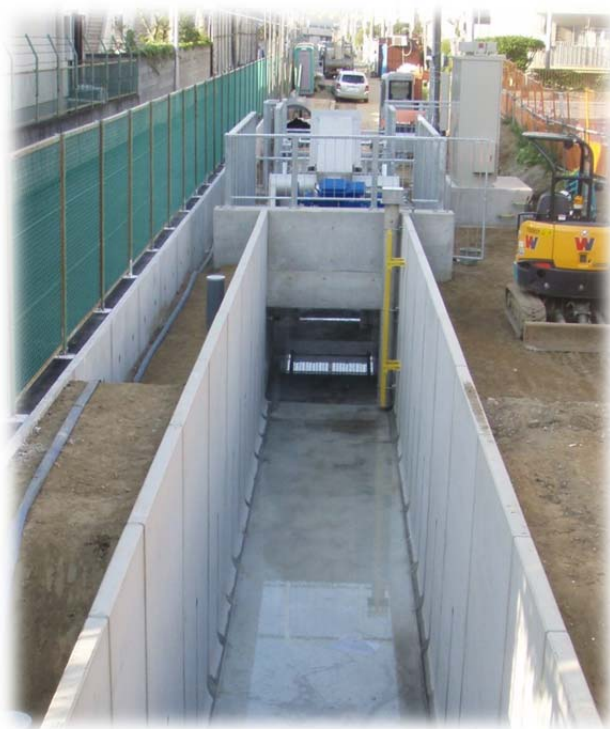
ポンプゲート
